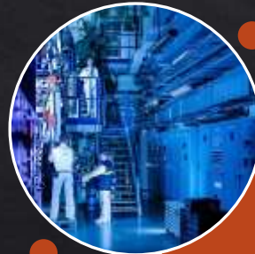
Exploitation (production / maintenance)
